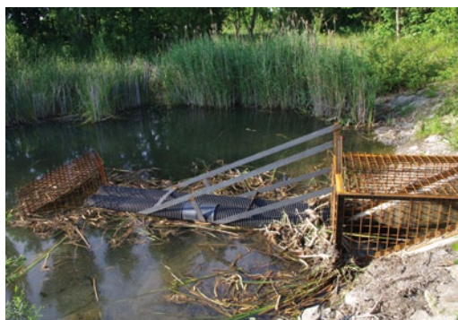
Obrázek 25 Ochrana propustku předsaženou ocelovou klecí na nátoku. Zajištění průtoku je posíleno vložením dvou plastových trub vytažených vysoko nad vtok do propustku. Jejich nátok je rovněž chráněn ochranným drátěným košem.
