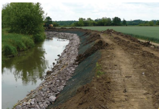
Obrázek 30: Pokládka pletiva do tělesa protipovodňové hráze na Kyjovce – svahy jsou chráněny pletivem proti prohrabání, spodní část koryta kamennou rovnaninou proti erozi břehu.
