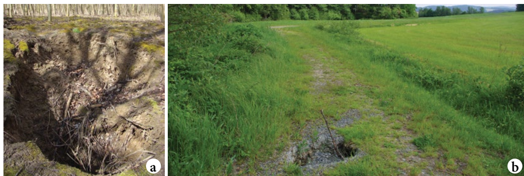
Obrázek 32: Propadlá nora na břehu toku (a); propadlá cesta (b).
