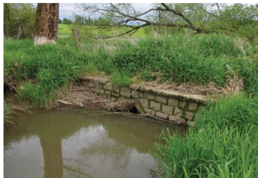
Obrázek 24: Částečně ucpaný propustek nežádoucí aktivitou bobra.
