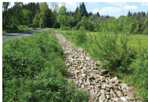
Obrázek 21: Cestní příkop zasypaný hrubozrnným materiálem. Dříve zde byla občasná vodoteč, kde bobr stavěl hráz, vzdouval vodu a ohrožoval tak cestní těleso.
