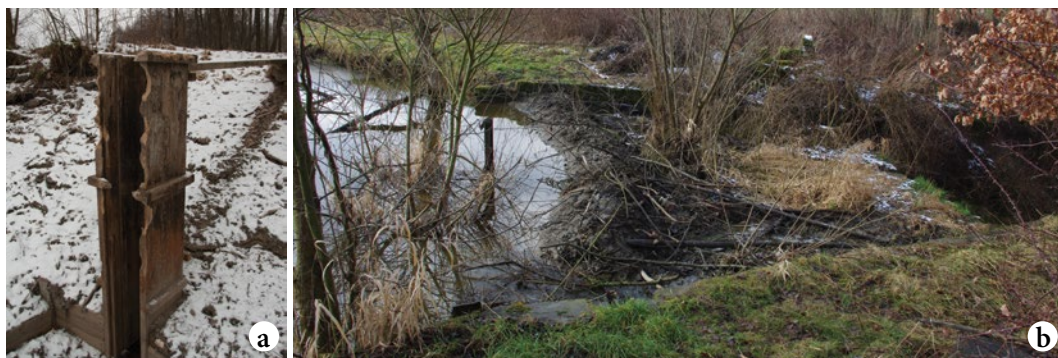
Obrázek 34: Bobrem poškozený požerák (a); bobří hráz na bezpečnostním přelivu (b).
