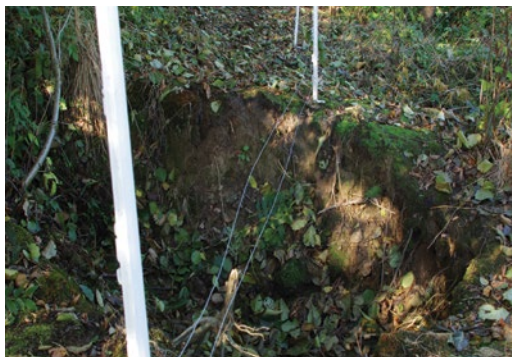
Obrázek 11: Nesprávně provedené opatření – bobr pod ohradníkem může prolézt.
