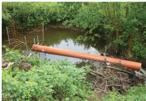
Obrázek 19: Nesprávně provedené drénování hráze, trouba po osazení nebyla překryta (tj. hráz nebyla dostavěna), voda navíc dopadá za hrází z výšky, což způsobuje nežádoucí hluk.
