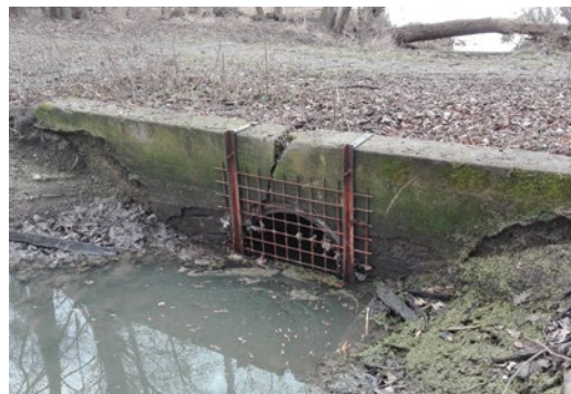
Obrázek 26: Nesprávně provedená ochrana propustku – mříž může být velice rychle ucpána a může tím být ohrožena stabilita propustku a zemního tělesa komunikace. Toto řešení je velmi rizikové samo o sobě i v případě, že na lokalitě není bobr.
